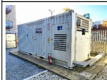
#5: Gruppo Elettrogeno Cogen XFA0010
