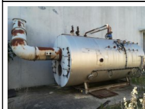
#58: Centrale Termica e Bruciatore
