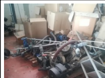
#49: Motori Elettrici per Impianto di Depurazione - A
