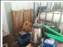
#50: Motori Elettrici per Impianto di Depurazione - B
