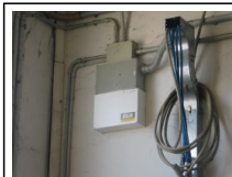
#11: Impianto di Allarme
