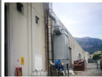
#2: Impianto Aspirazione Polveri
