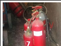
#10: Estintori e Cassette Primo Soccorso
